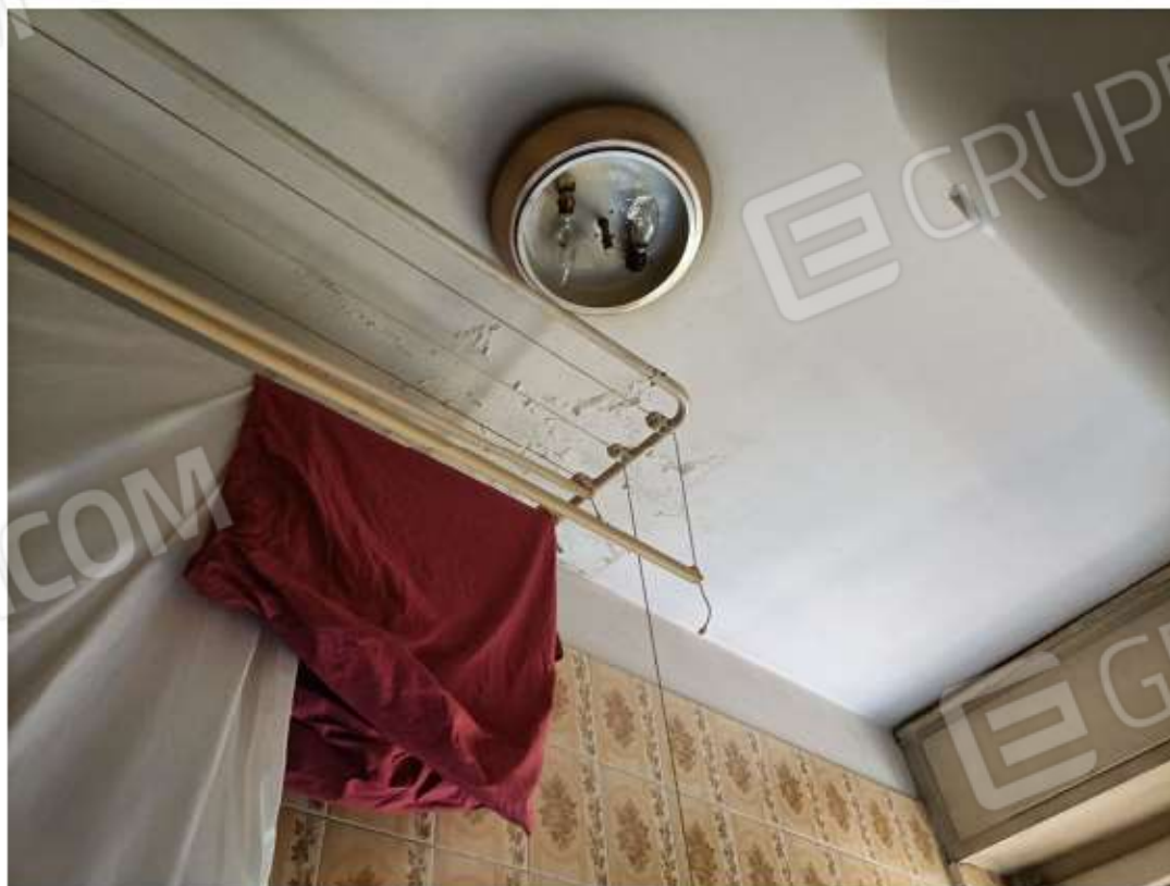
Infiltrazione presente in bagno
