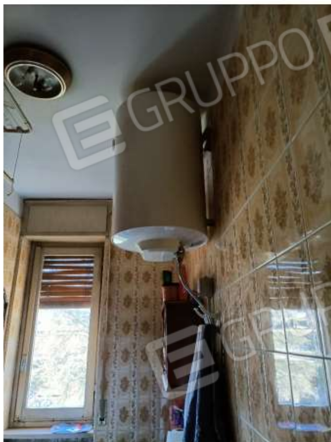
Impianto – boiler elettrico
