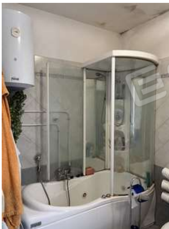
FOTO 8: CONFRONTO: SOPRALLUOGO 2021 stato del soffitto
