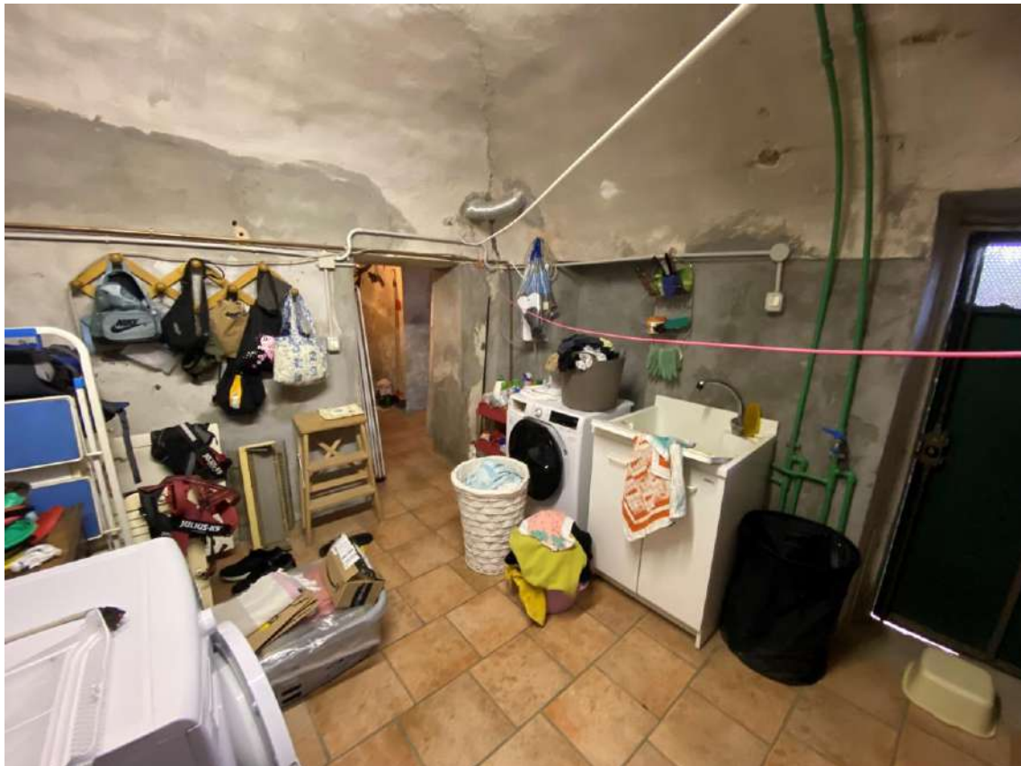
FOTO 13 : VISTA D'INSIEME INTERNA PIANO TERRENO CENTRALE TERMICA
