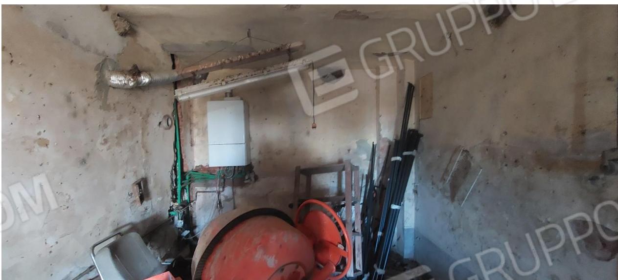
FOTO 30 – Ripostiglio – Centrale Termica piano terreno
