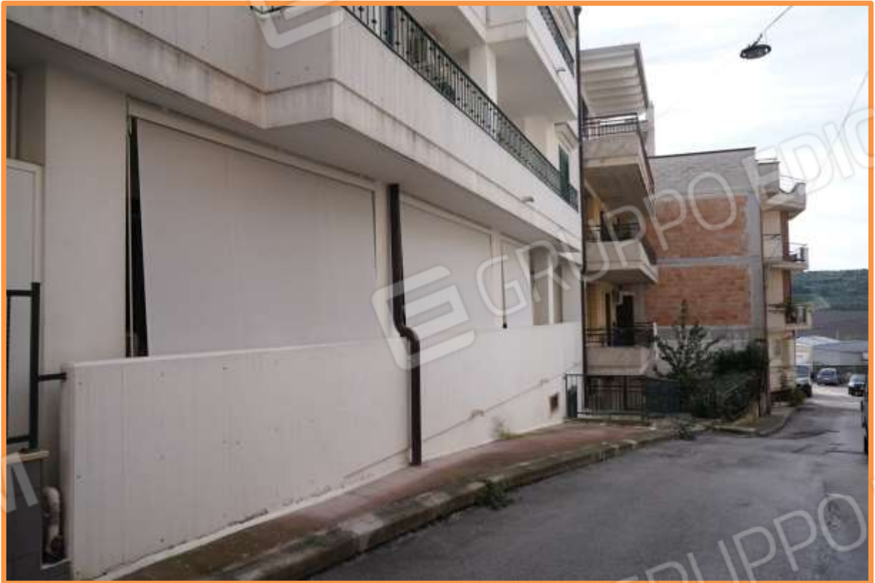
FOTO n° 2. Come foto n° 1. Vista verso la direzione sud. Particolari del prospetto dell'edificio verso [REDAZIONE], a ovest. La porzione di piano terra/rialzato afferisce all'unità immobiliare staggita.
