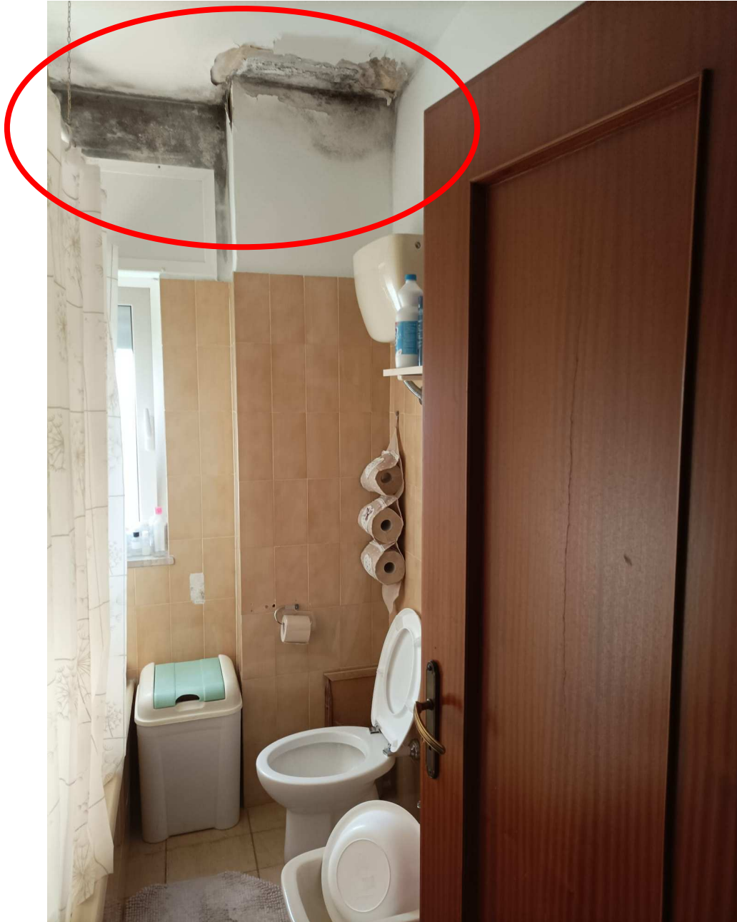
Foto n°7: Bagno con evidenti fenomeni di muffa
