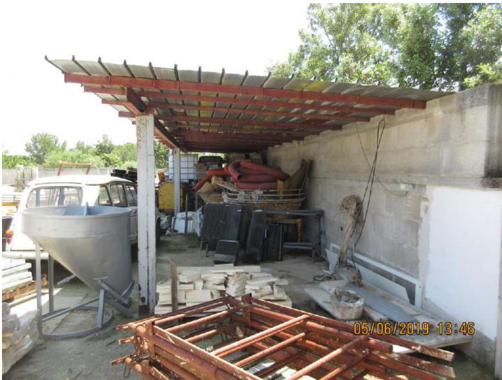
Foto n. 56 Piccola tettoia circa 47,00 mq abusiva
