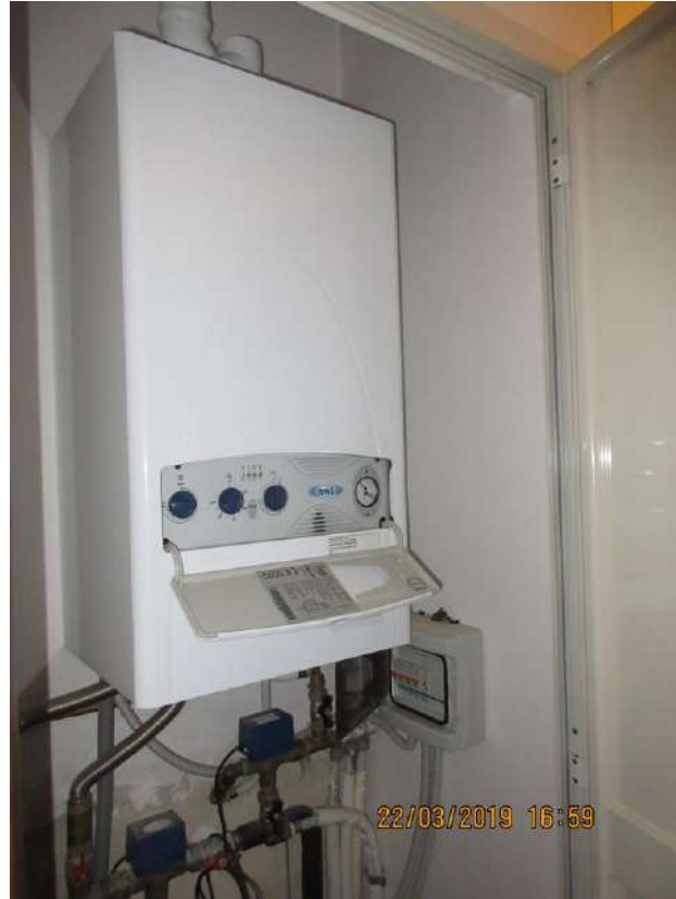
Foto n.85 Caldaia murale a gas della villa
