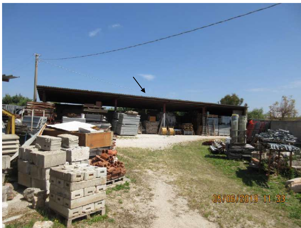
Foto n. 54 Grande Tettoia superficie circa 250,00 mq abusiva
