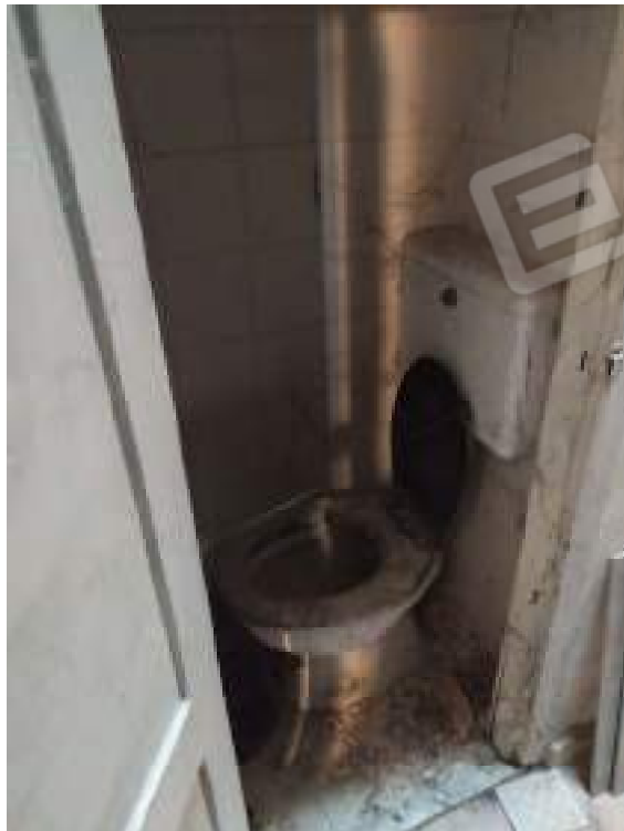
Foto 10 – servizio igienico incompleto piano terra
