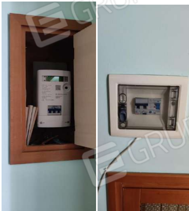
Foto nn. 17, 18. Contatore energia e relativo quadro elettrico
