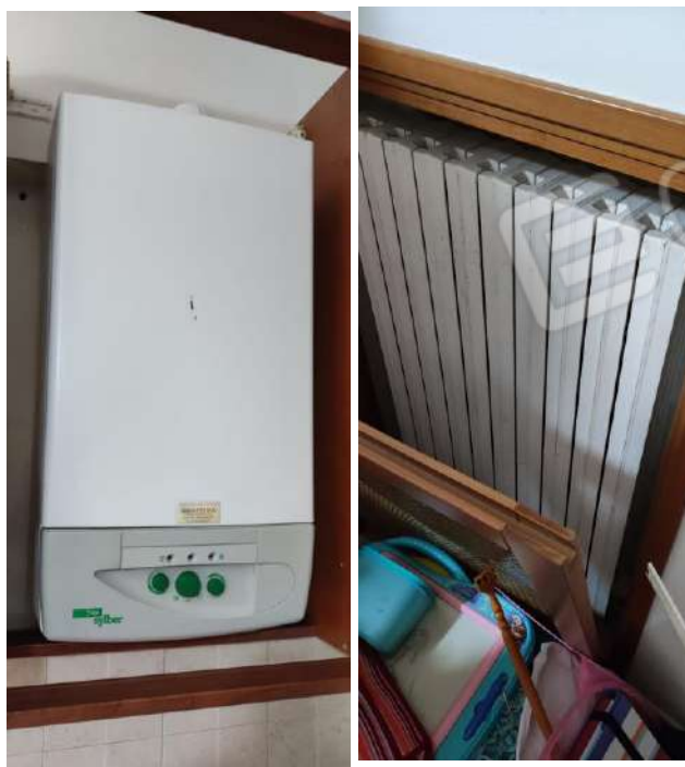
Foto nn. 19, 20. Caldaia e corpo radiante
