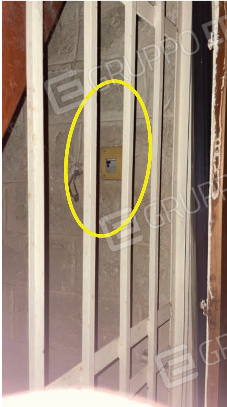
Interno- Particolare differenziale impianto elettrico esistente
