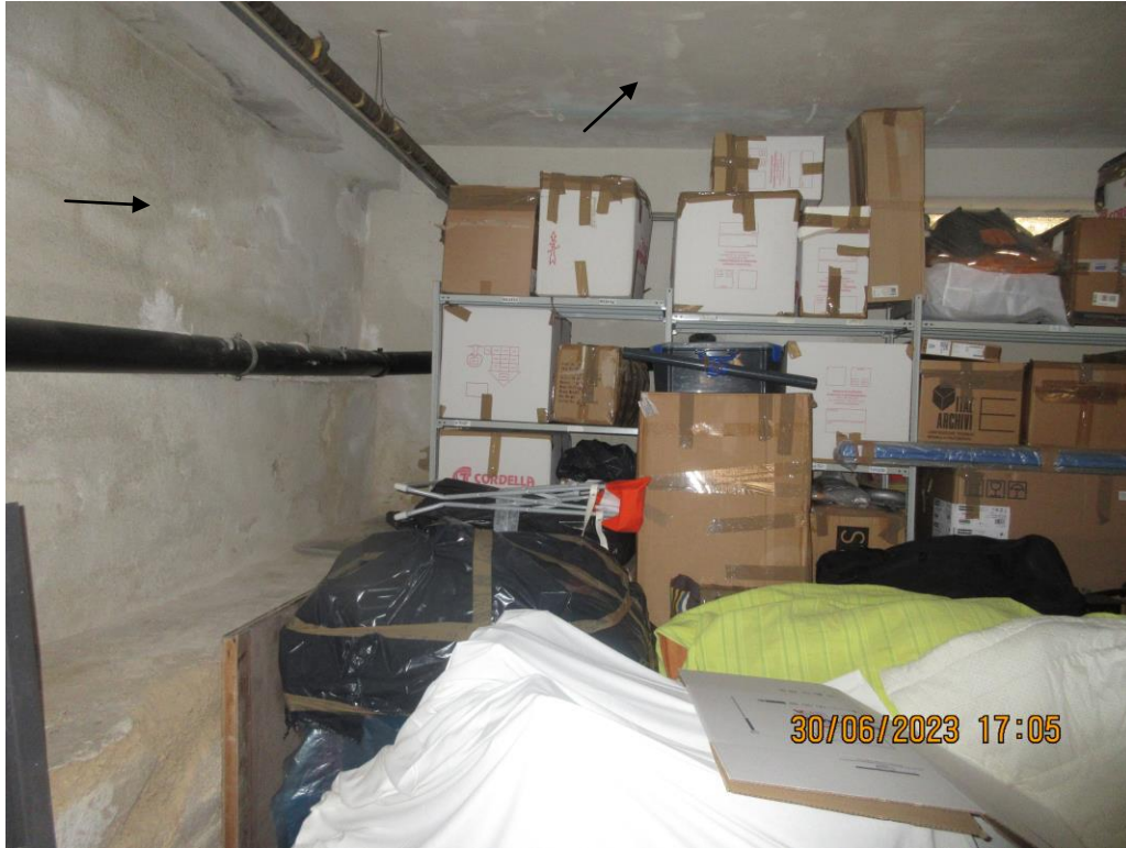
Foto n.13 Generali scadenti condizioni delle pareti e solaio del locale
