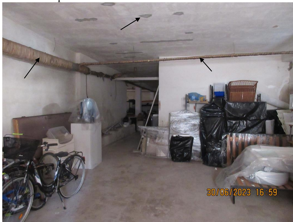
Foto n.6 : Scadenti condizioni dell'intradosso del solaio e delle pareti
