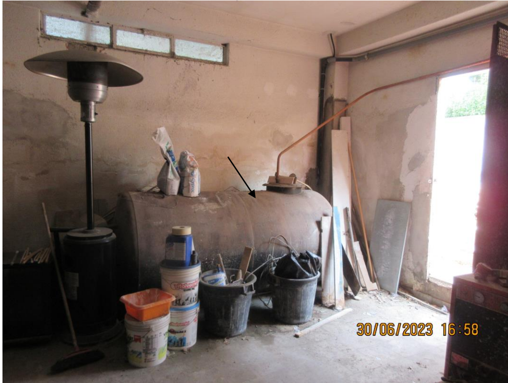
Foto n.7: Serbatoio di accumulo gasolio dell'impianto di riscaldamento centralizzato dismesso da tempo
