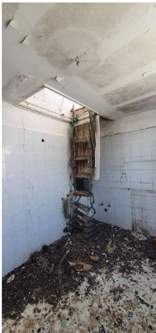
Foto n.18 : Scala metallica rotta con conseguente impossibilità di verificare le condizioni del lastrico solare
