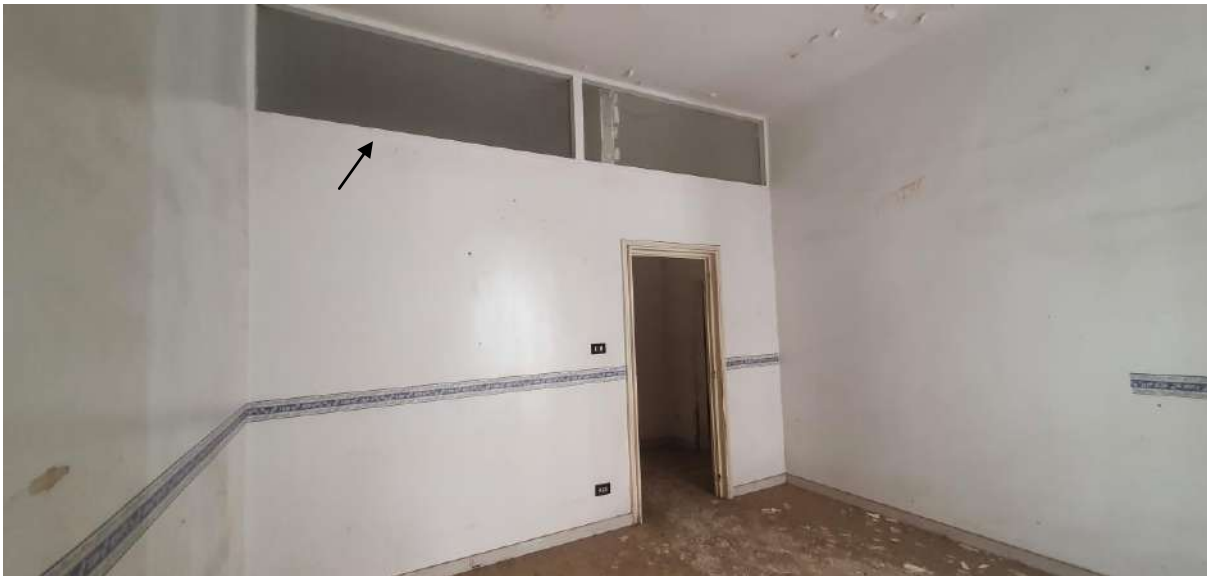
Foto n.8 : Vano principale in scadenti condizioni
