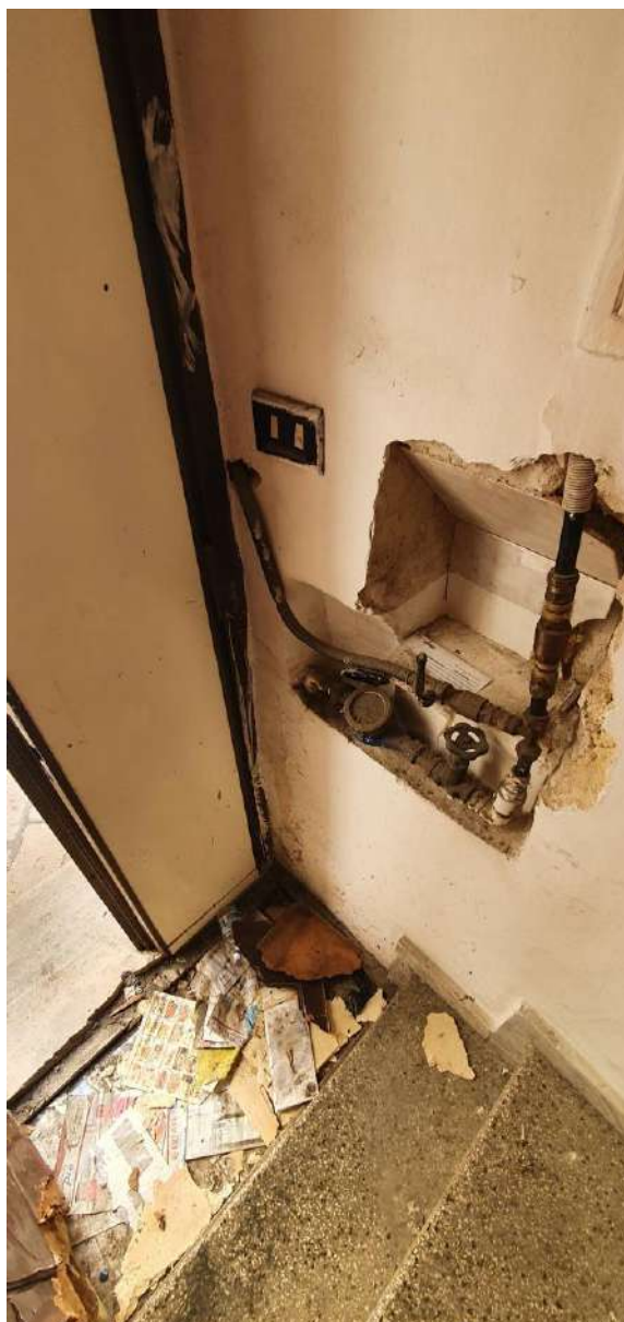
Foto n.21 Contatore idrico a sx rispetto all'ingresso
