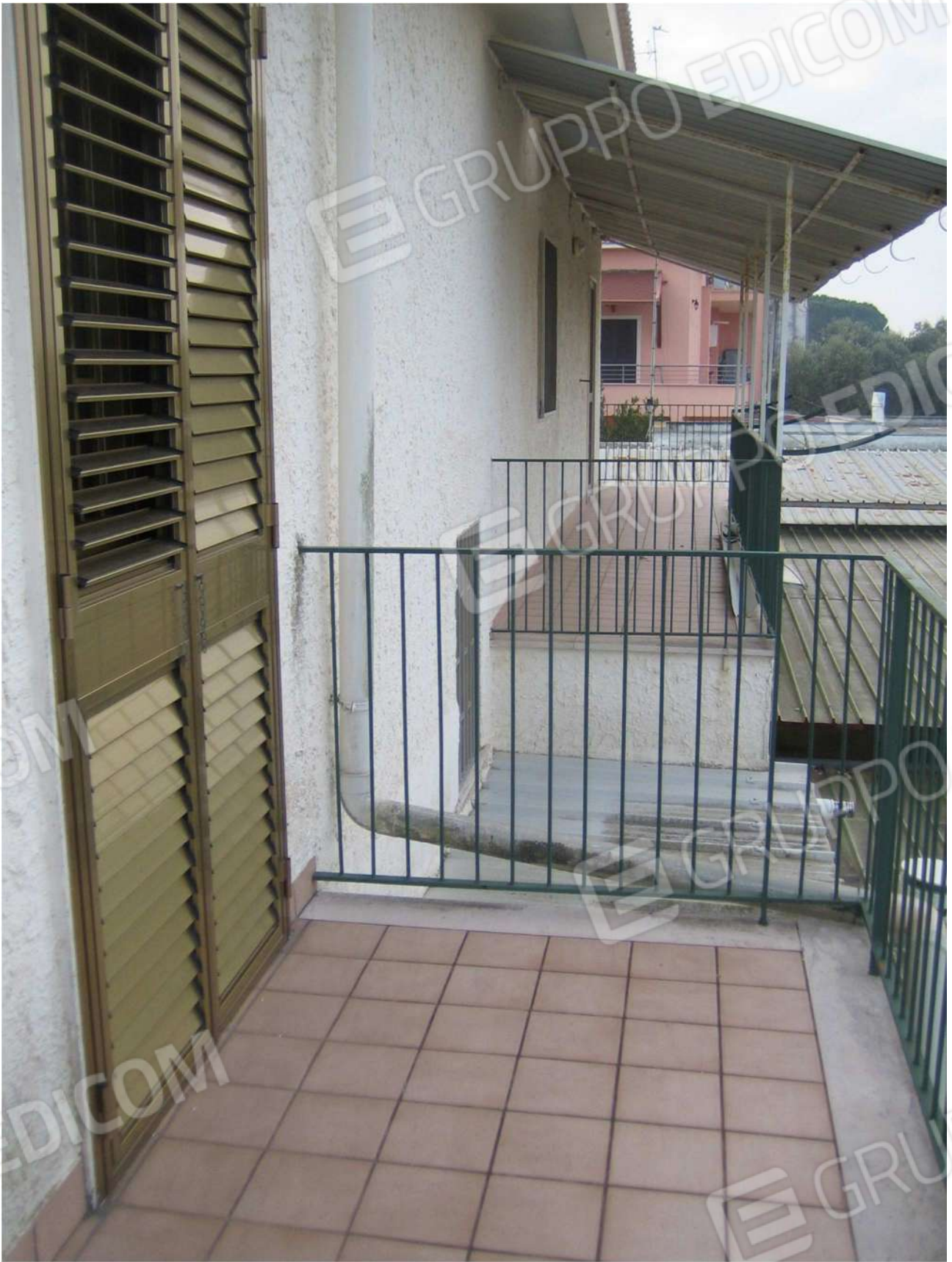
Foto n° 30 - balcone A19 al piano primo dell'Immobile pignorato
