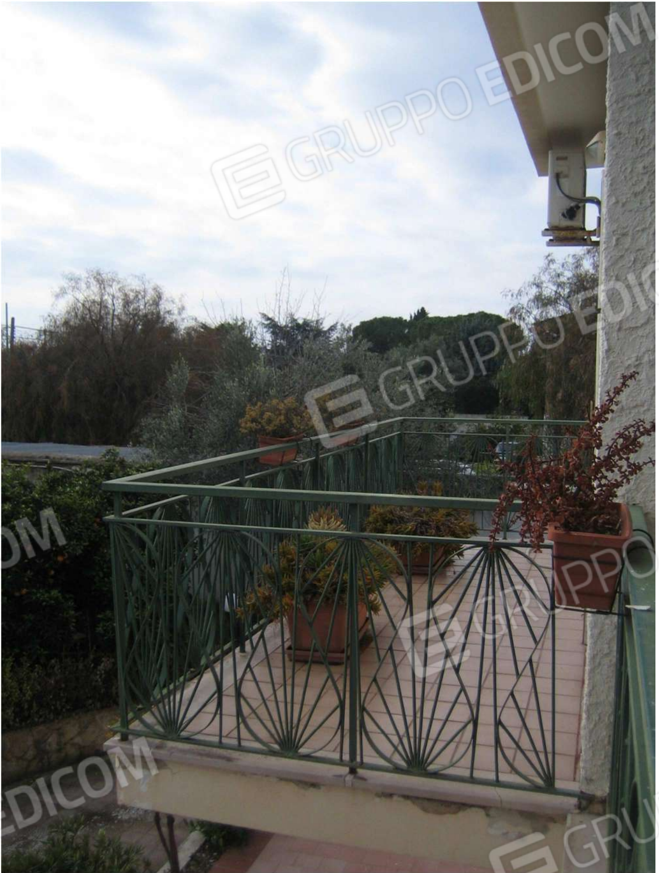
Foto n° 34 – balcone A21 al piano primo dell'Immobile pignorato
