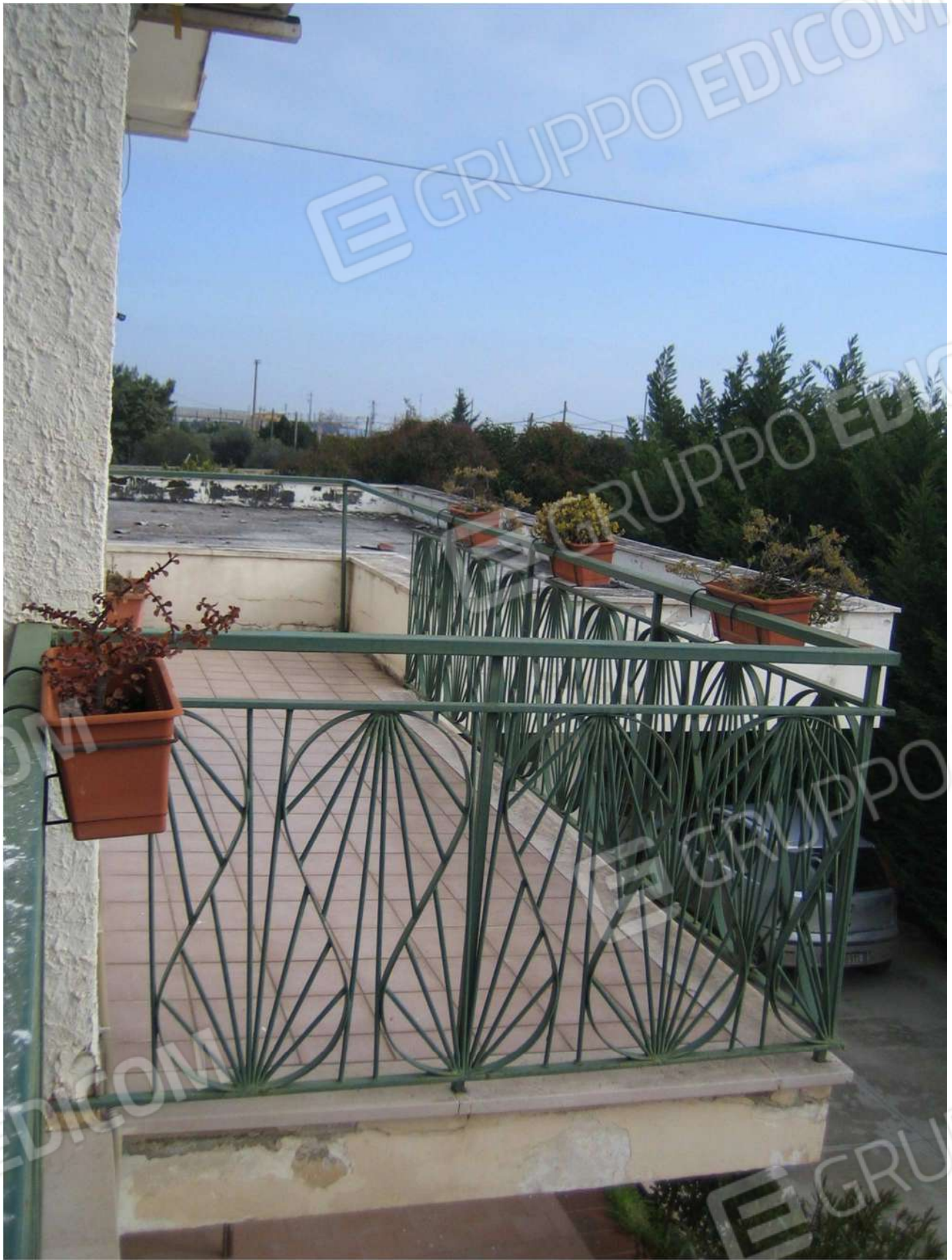
Foto n° 25 – balcone A15 al piano primo dell'Immobile pignorato
