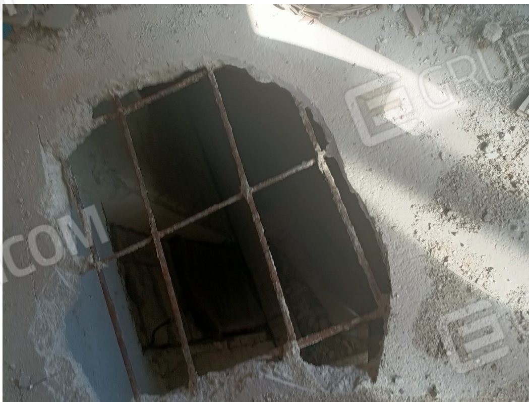
Presenza di un foro sul pavimento al piano primo
