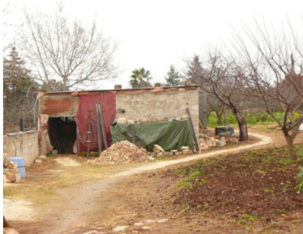
Fabbricato abusivo (corpo C)
