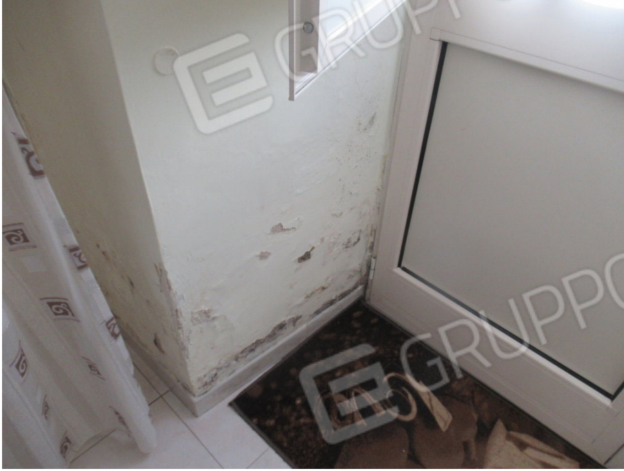
Porta ingresso – dettaglio umidità risalita
