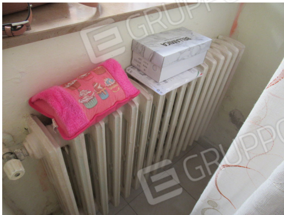
Soggiorno – dettaglio umidità risalita
