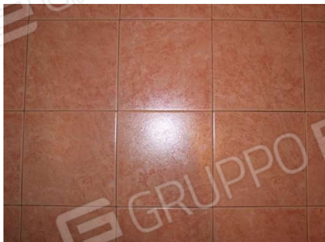
Foto 36 - Particolare pavimentazione bagno WC2
