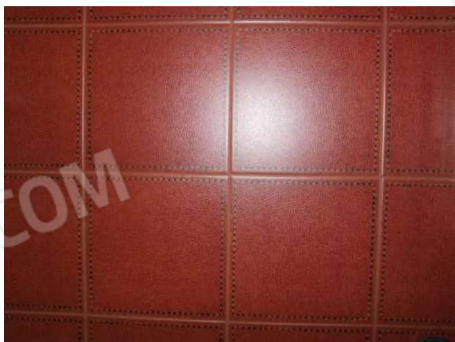
Foto 35 - Particolare pavimentazione bagno WC1
