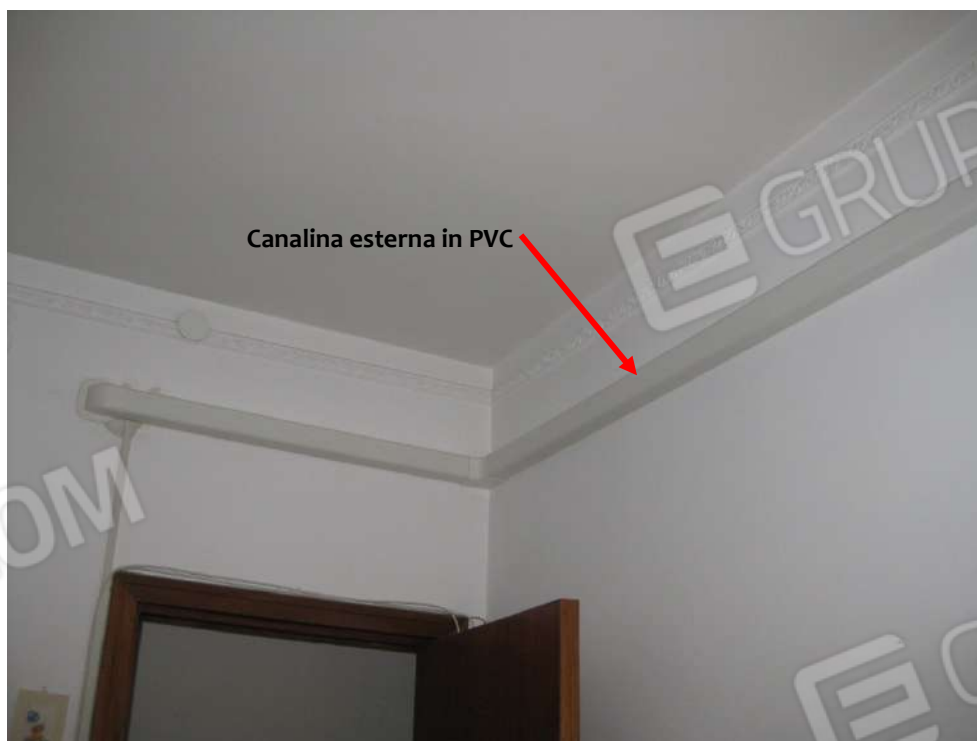
Foto 38: Particolare della canalina esterna in PVC a protezione della tubazione in rame per collegamento tra l'unità interna a parete (split) e l'unità esterna installata sul balcone
