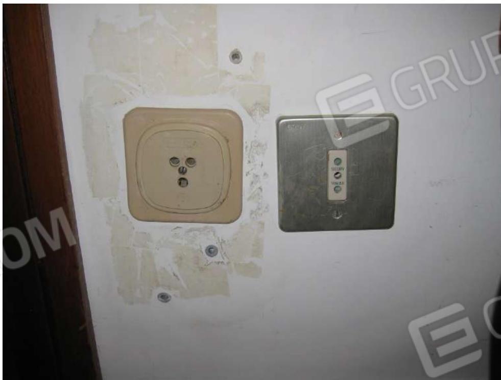
Foto 40: Particolare presa elettrica e presa telefonica
