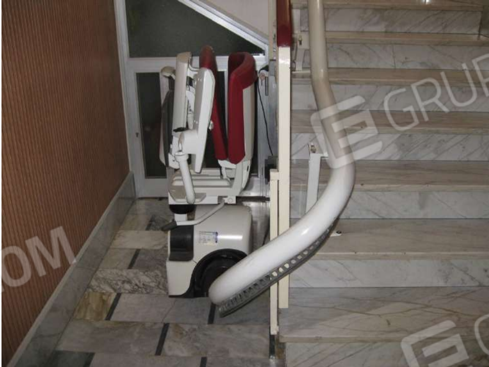
Foto 8: Particolare del servoscala installato dal Sig. XXXXXXXXXXXXXXXXXXXX
