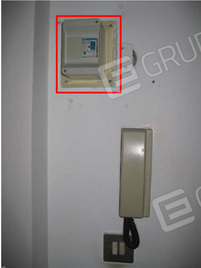
Foto 13: Salvavita generale a monte dell'impianto
