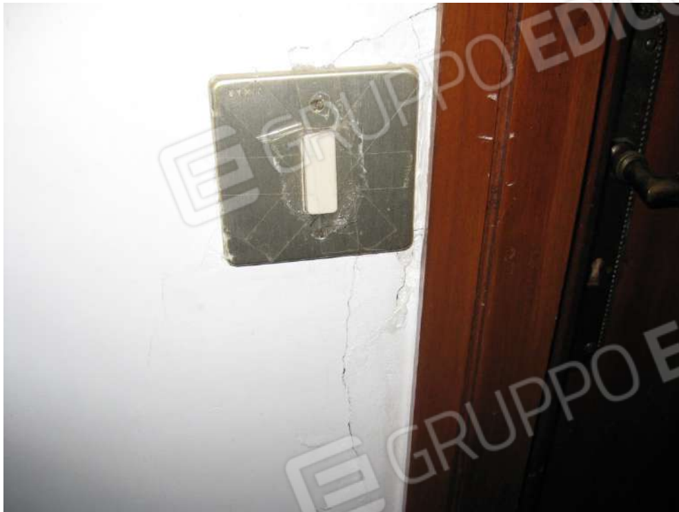
Foto 39: Particolare interruttore. Si possono vedere i pezzi di nastro adesivo per mantenerlo fissato a parete
