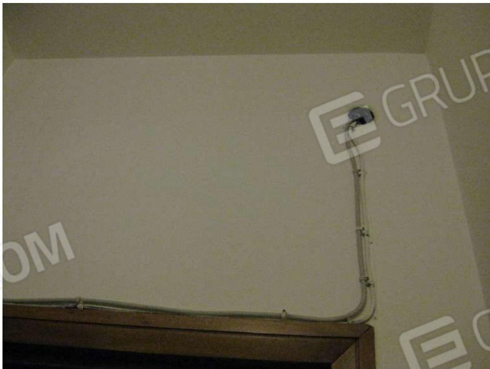
Foto 26: Particolare di cavi gommati elettrici esterni fissati a parete con graffette in plastica
