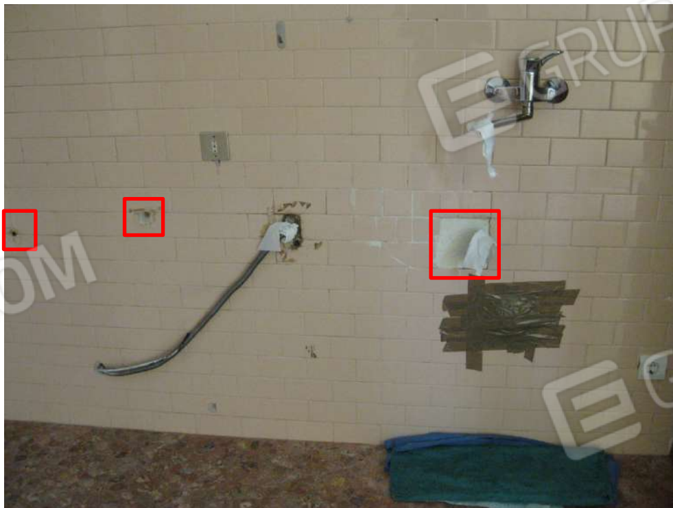
Foto 20: Particolare del muro dove era installata la cucina e lavandino. Si possono notare i fori e parte di rivestimento mancante
