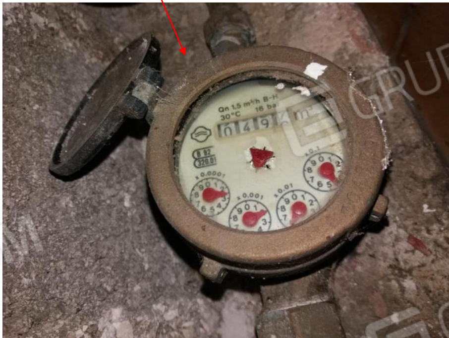
Foto n. 17 Contatore idrico funzionante
