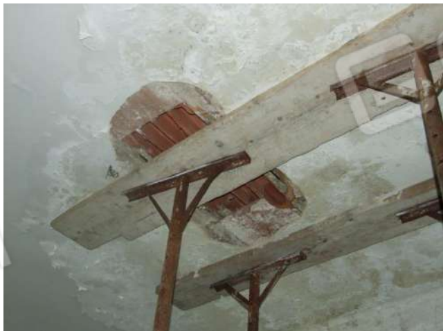
Foto 31 - Vano 1 - Zona ammalorata e puntellata
