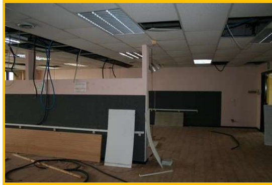
Particolare impianto elettrico
