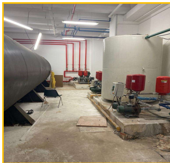
Centrale idrica e antincendio
