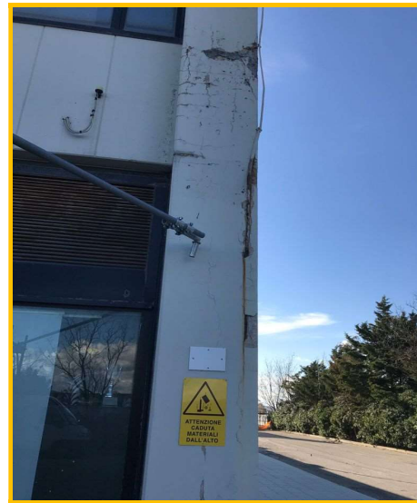
Particolare prospetto dello stato di ammaloramento
