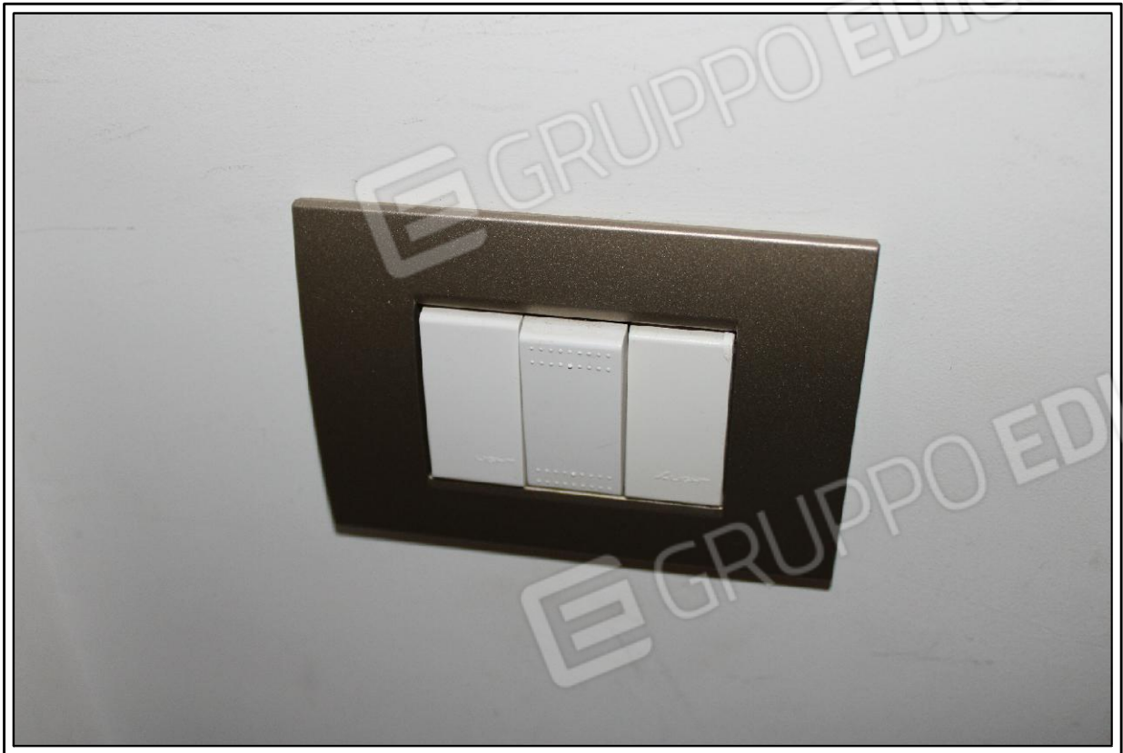
FOTO N° 35 - PARTICOLARE IMPIANTO ELETTRICO
