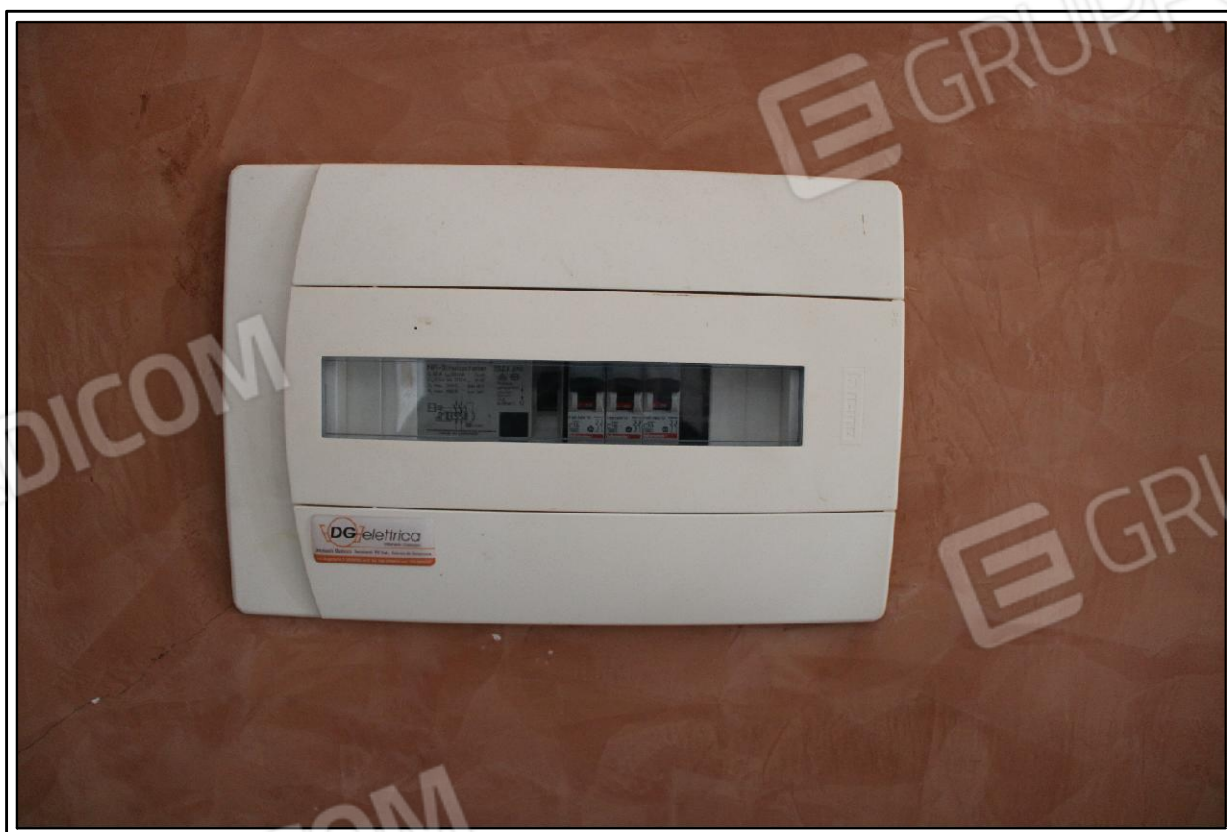
FOTO N° 34 - PARTICOLARE IMPIANTO ELETTRICO
