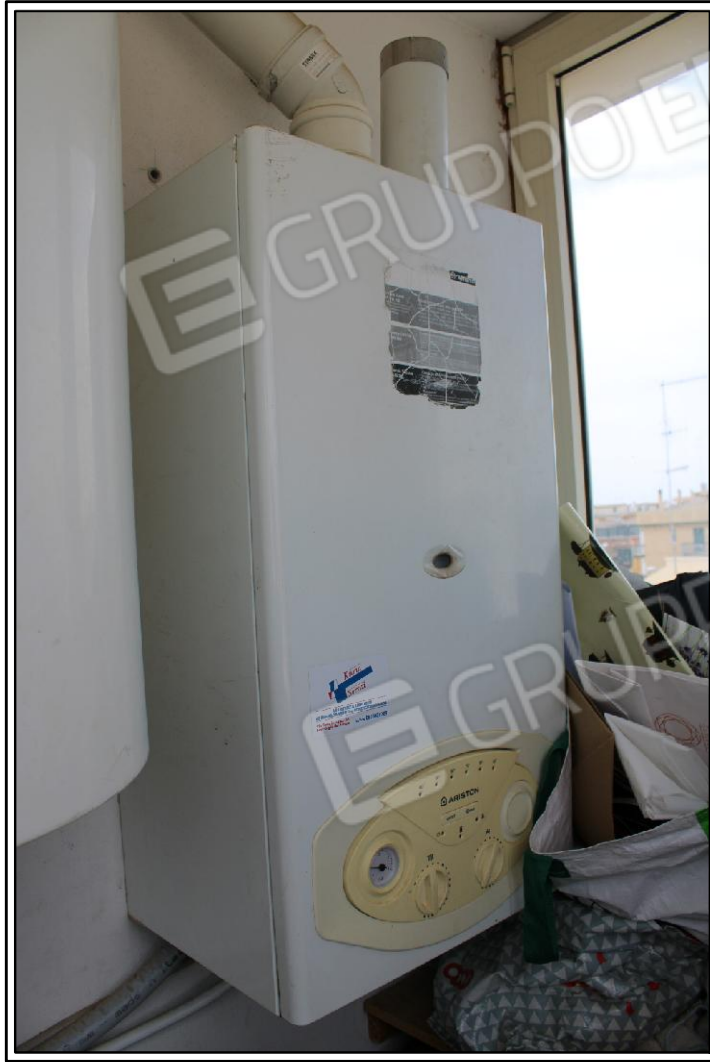
FOTO N° 39 - PARTICOLARE IMPIANTO DI RISCALDAMENTO E PROD. ACS
