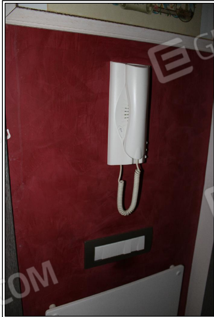
FOTO N° 38 - PARTICOLARE IMPIANTO CITOFONICO
