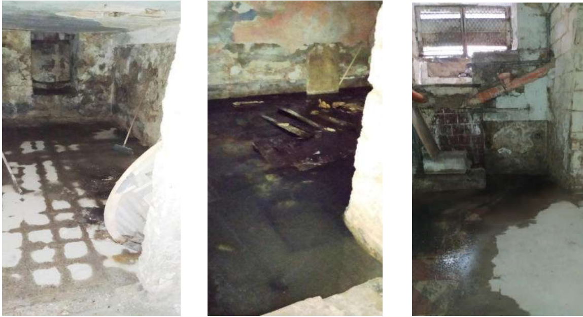
Locale allagato a causa di infiltrazioni
