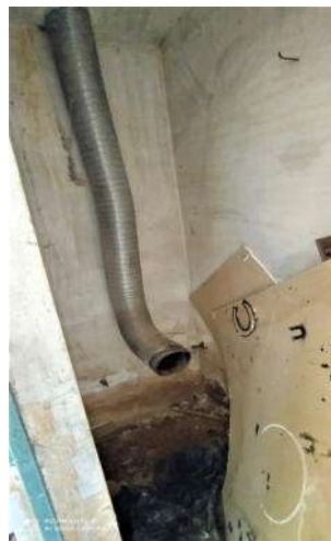
Locale caldaia nel patio retrostante
