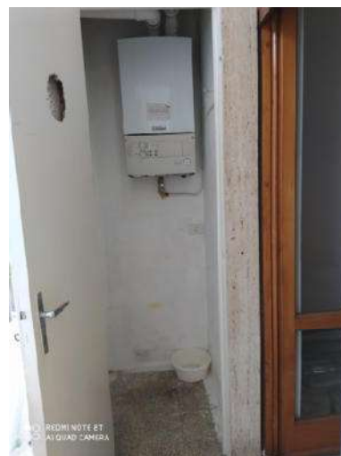
Ripostiglio veranda con caldaia a gas
