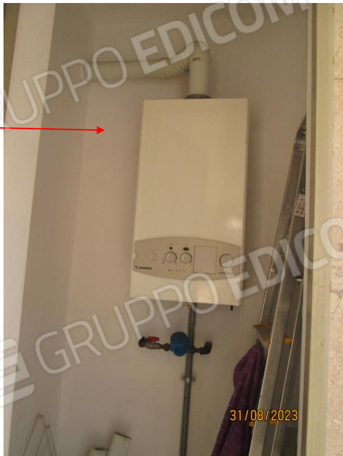
Foto n. 20: Caldaia nel Vano del balcone
