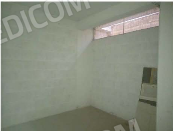
Vista interna locale Box
