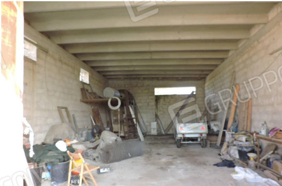
Locale deposito privo di titolo edilizio a demolirsi.
