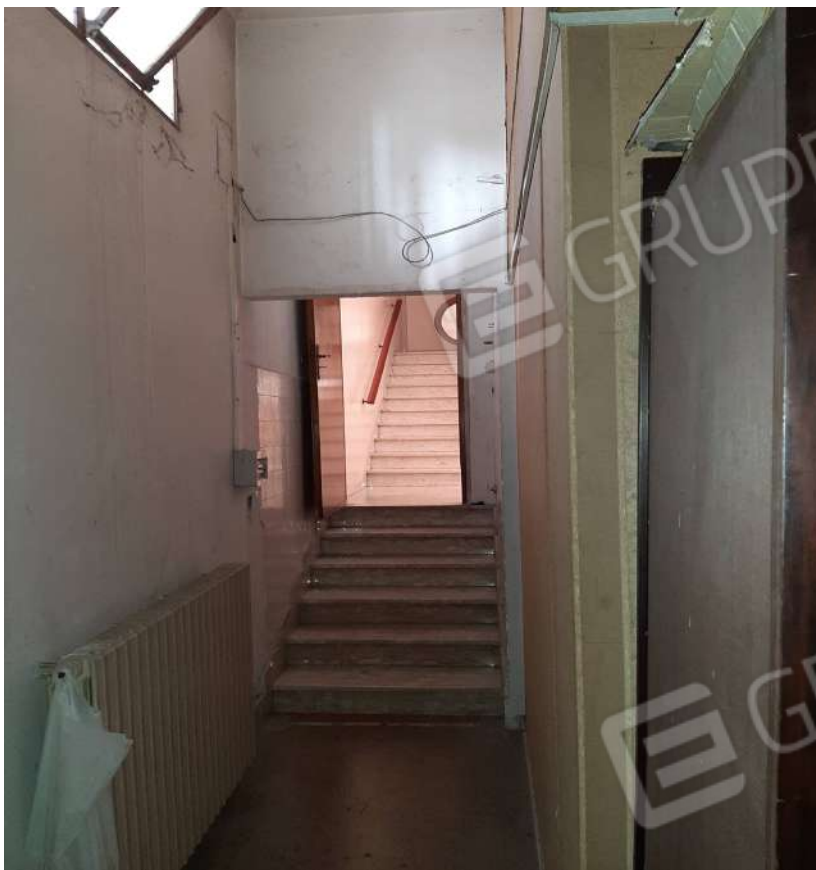
Foto n. 12 Scala da demolire che accede a porta da murare sul pianerottolo vano scala n.c. 5
