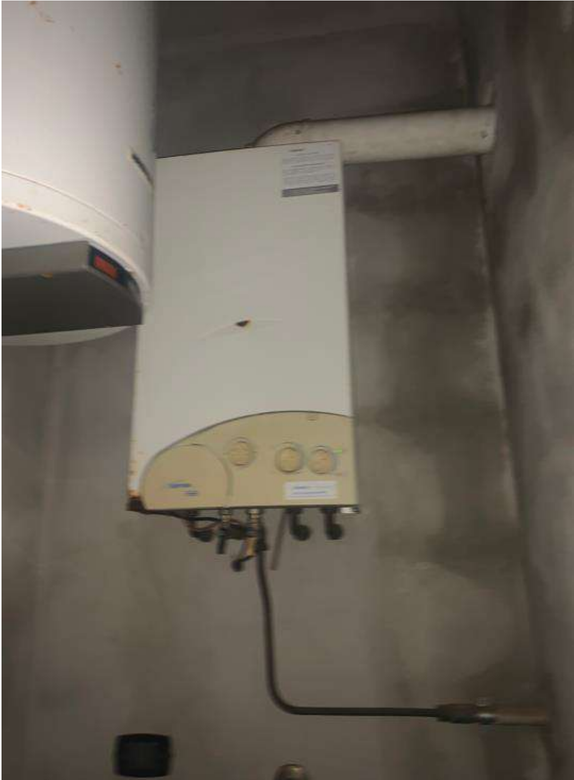
CENTRALE TERMICA PIANO PRIMO
