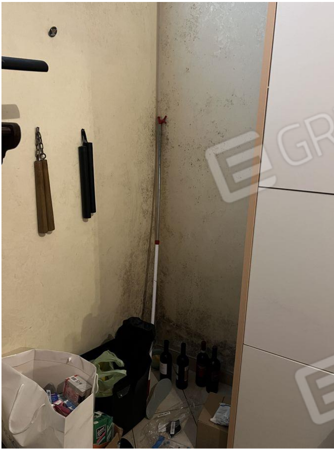
Foto 19 – Particolare angolo parete esterna verso il porticato condominiale con presenza di muffe
