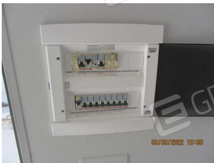
FOTO N° 99: VISTA DEL QUADRO GENERALE LINEE ELETTRICHE E DELL'INTERRUTTORE DIFFERENZIALE.
