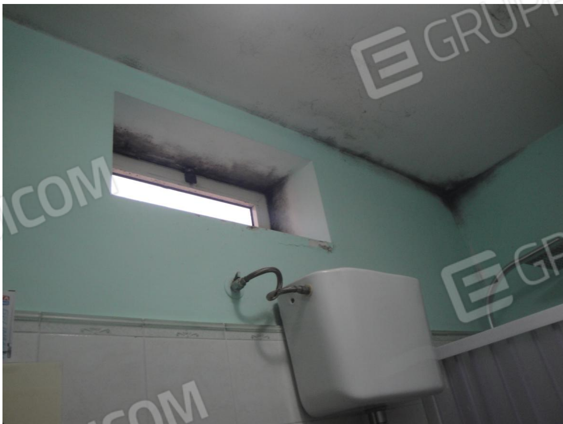
Foto 16: Unità abitativa posta in Casalnuovo Monterotaro ai piani T-1 di Via Galliano n. 9-11-13. Macchie e annerimenti soffitto piano primo.
