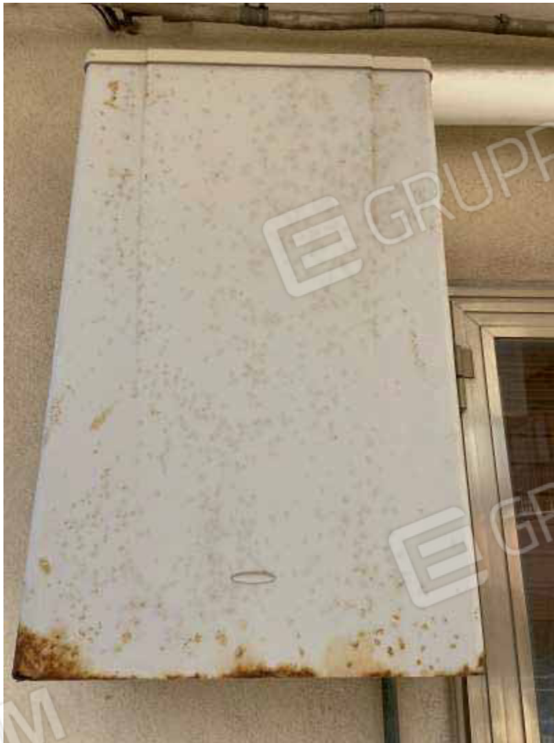
Foto 16) – Caldaia (IMMOBILE A)
