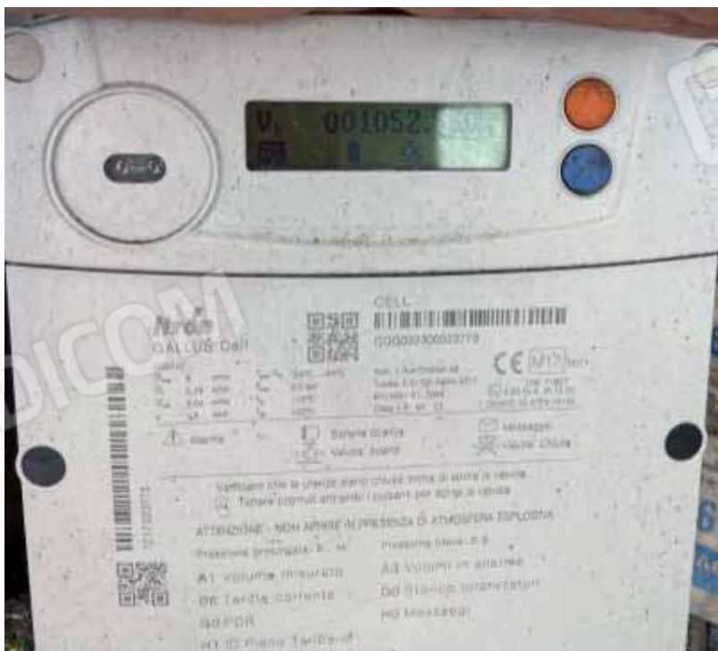
Foto 17) – Contatore energia elettrica (IMMOBILE A)
