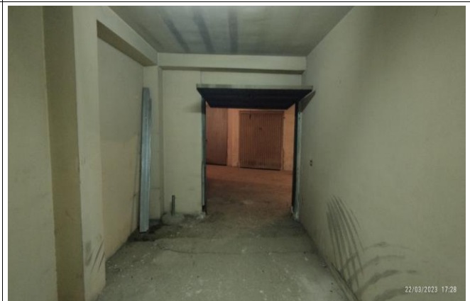
Foto 19 Vista interna del box
