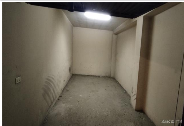
Foto 18 Vista interna del box
