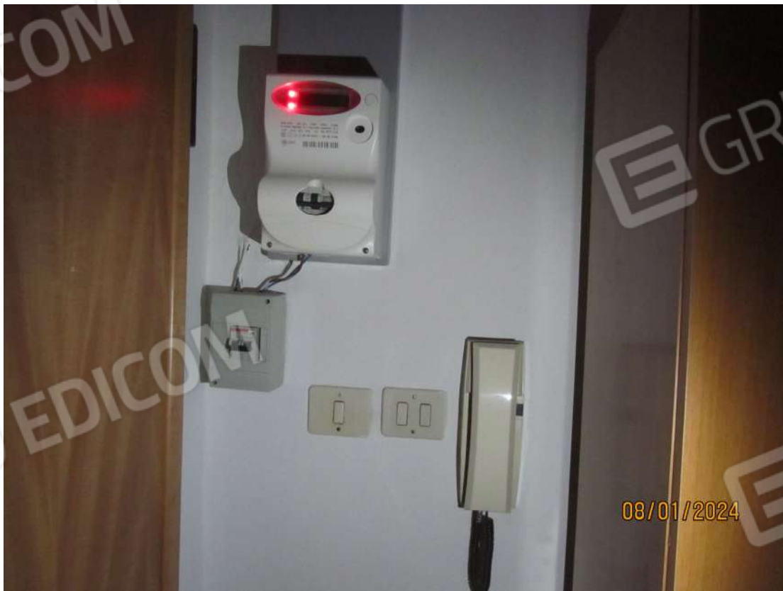
FOTO N.16 - Particolare interruttori elettrici e citofono.
