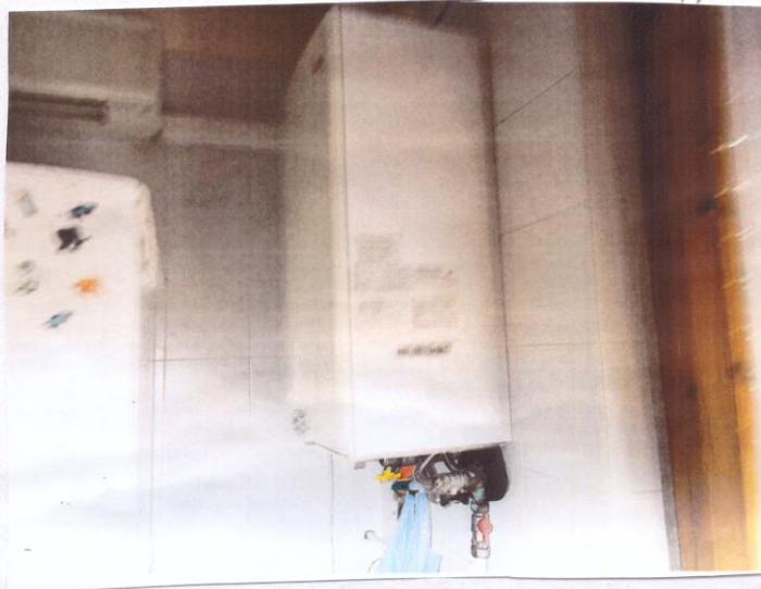
Foto n. 8 – Particolare della caldaia alimentata a gas
