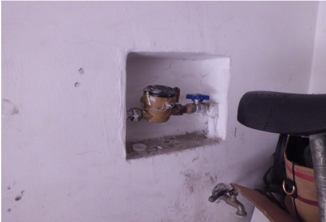
FOTO N. 5 – LOCALE BOX FORNITO DI IMPIANTO IDRICO
