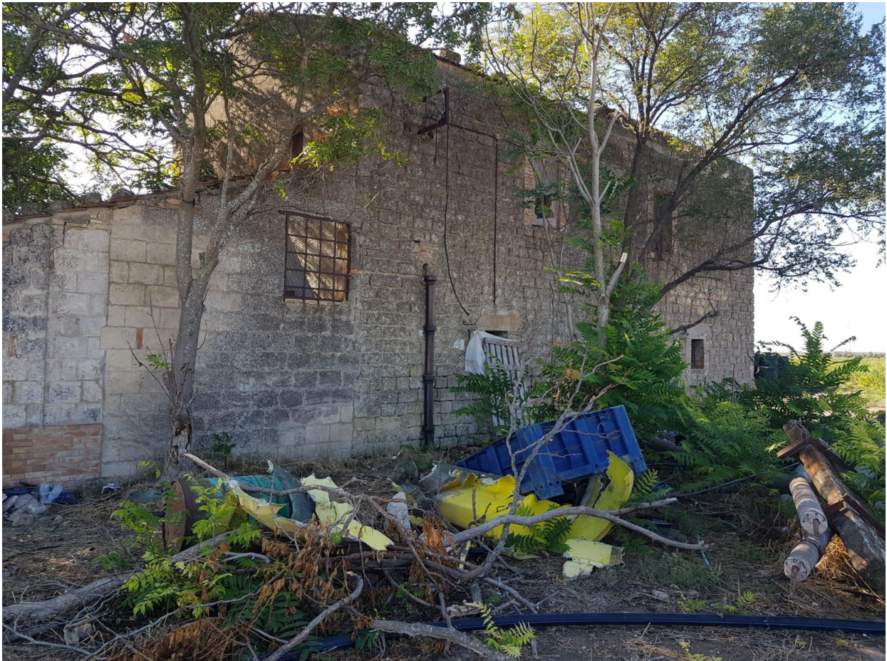
Foto 2 – Vista retro fabbricato diruto
