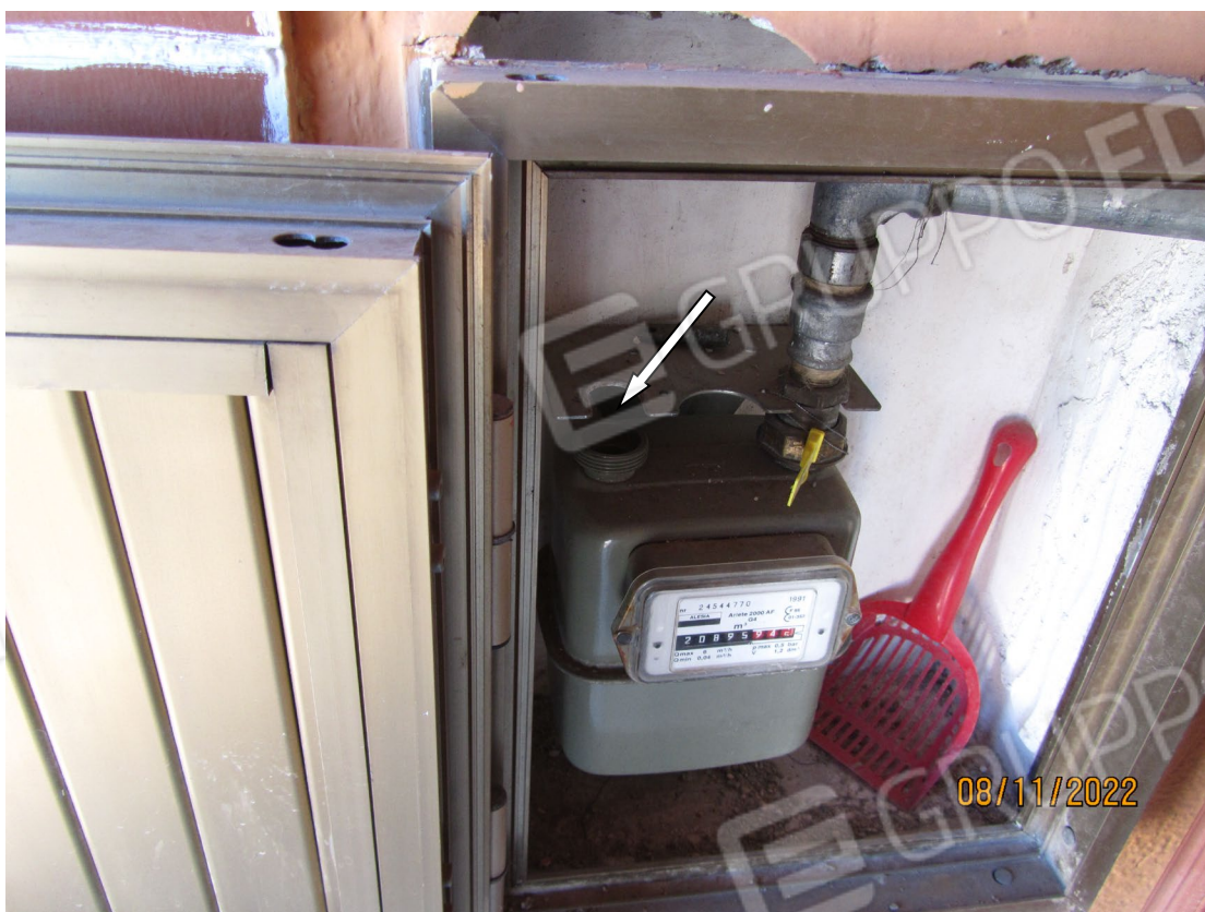
FOTO N.17 – Particolare contatore gas. La freccia evidenzia che lo stesso non è allacciato alla rete di distribuzione.
