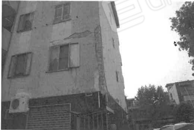
Foto n°7 Cadute di intonaco dalle pareti esterne dell'edificio
