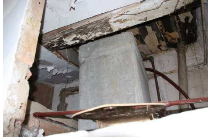
Vista cavedio con riserva idrica
