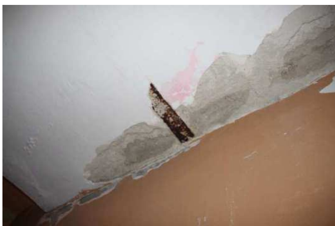
Vista soffitto piano terra (civ. 10) immobile
