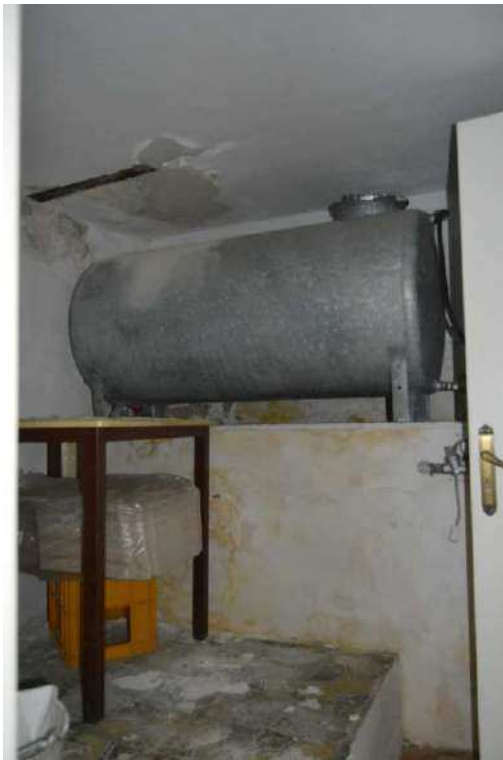
Vista locale tecnico
