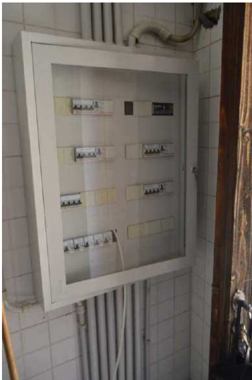
Vista quadro elettrico
