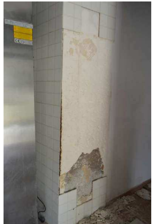
Vista piastrelle cadute varco cucina - deposito
