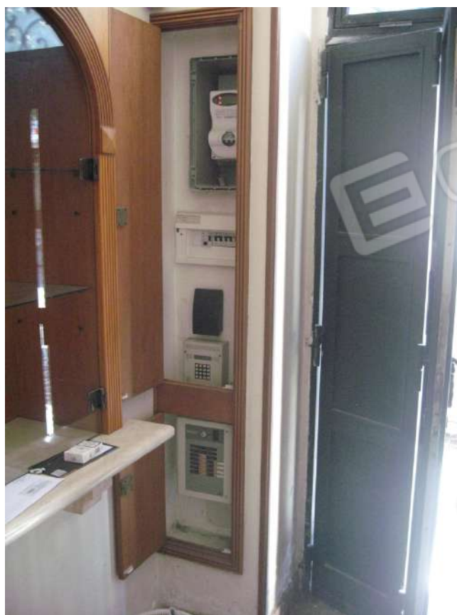
Foto n.16: sistema antifurto e quadro elettrico alloggiati all'interno di apposito vano rivestito
