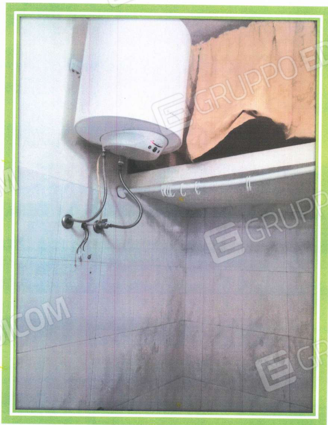
FOTO 11 BOILER NEL VANO BAGNO
