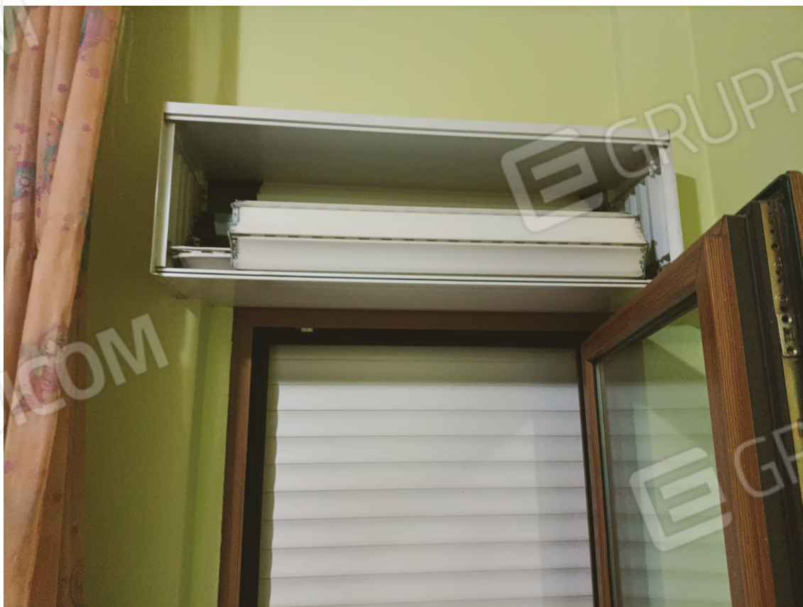
Rottura tapparella elettrica
