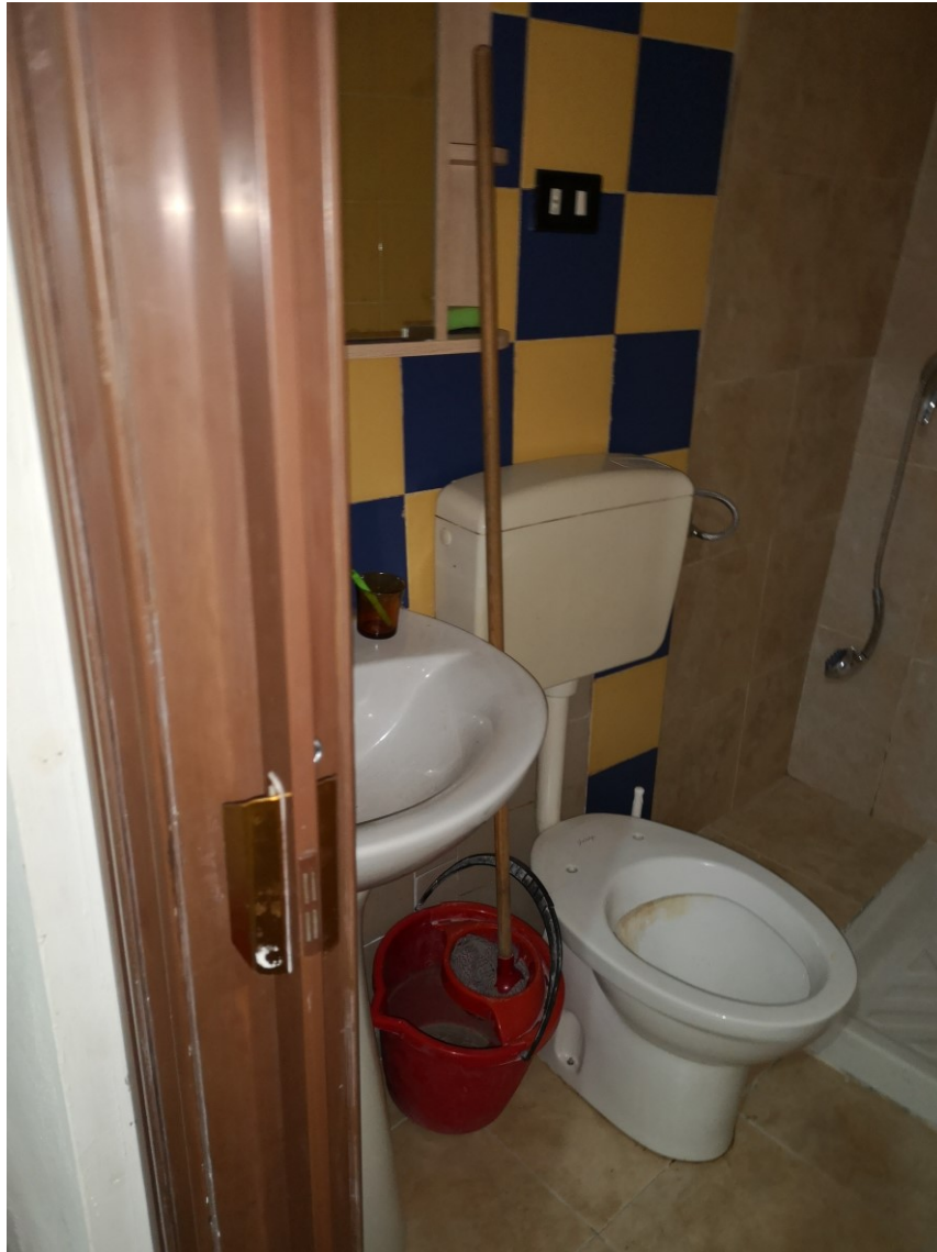
Figura 22 Particolare del Wc dell'immobile ubicato al piano terra in via Storto Castellana civ. 13 in San Giovanni Rotondo.
