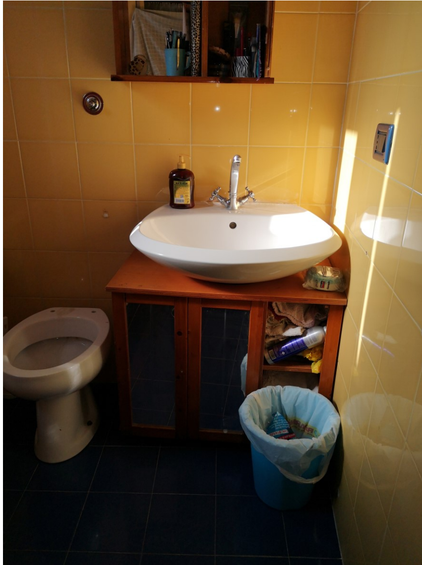
Figura 13 Particolare del lavabo del Wc posto al piano secondo.
