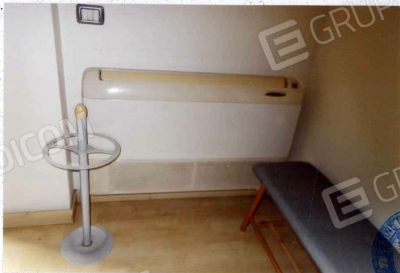
FOTO N. 10 – PARTICOLARE CONDIZIONATORE A PARETE
