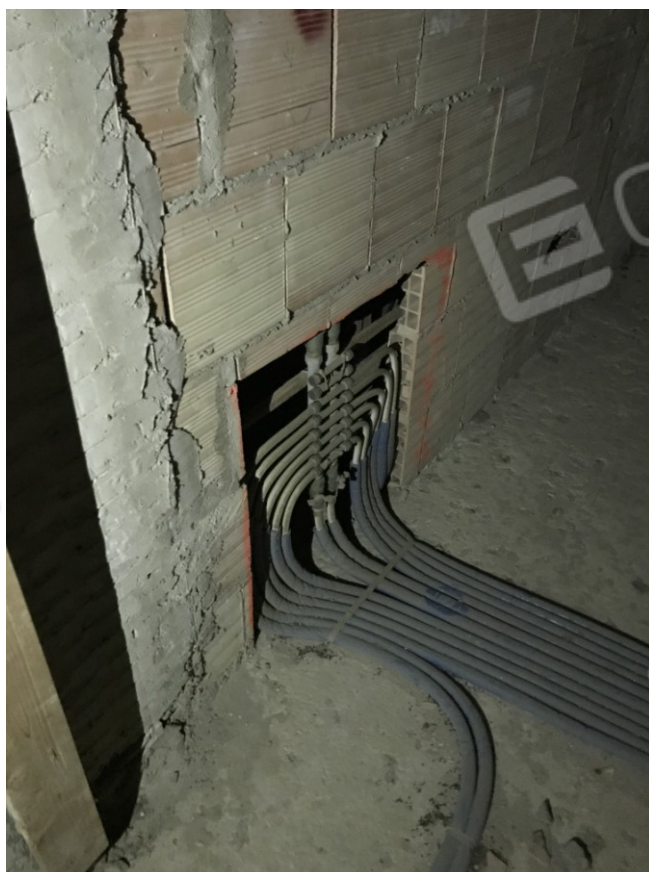
Foto n. 14: particolare collettore impianto di riscaldamento
