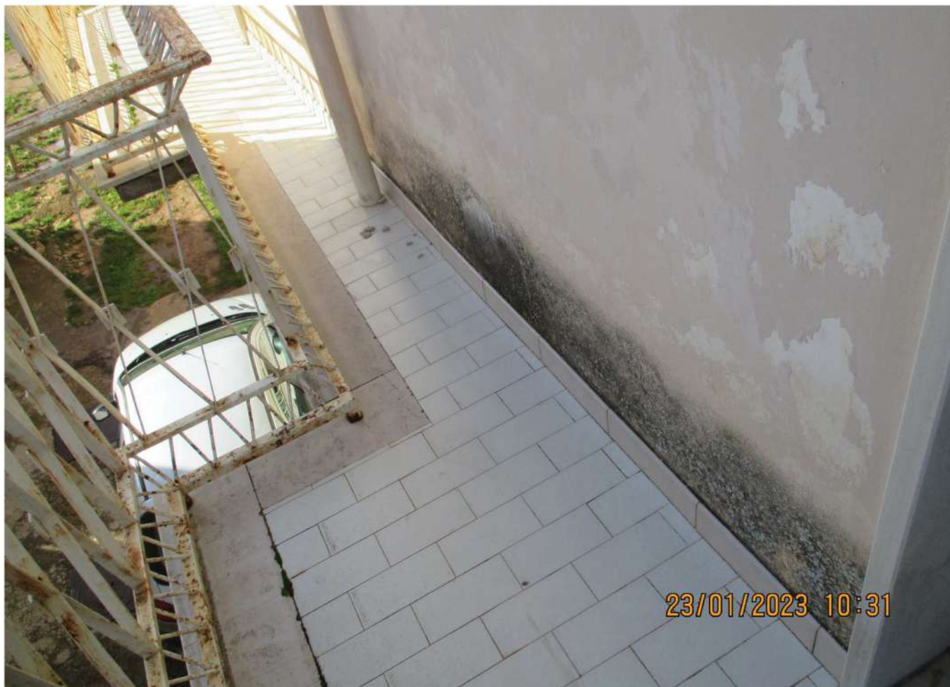
FOTO N°6 - PAVIMENTO DEL BALCONE 1° P.
