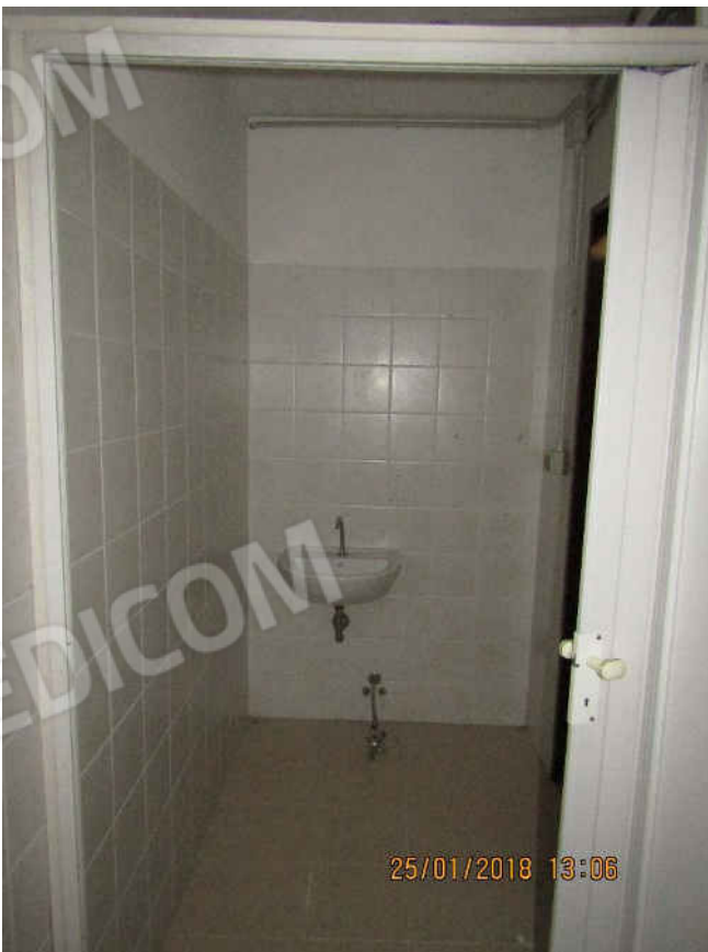
FOTO N. 34 – Locali commerciali al piano terra, particolare interno. Comune di San Ferdinando di Puglia (BT) Fgl. 13 p.lla 450 sub. 1, sub. 4.
